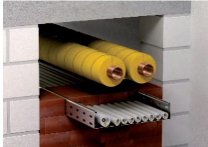
Durchgeführte nicht brennbare Rohre mit Streckenisolierung.
